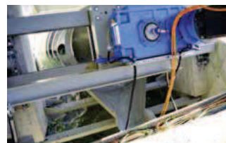
Widok na generator, hamulec, przekładnię, ujęcie wody górnej oraz rynnę, za pośrednictwem której odbywa się migracja ryb w górę rzeki
